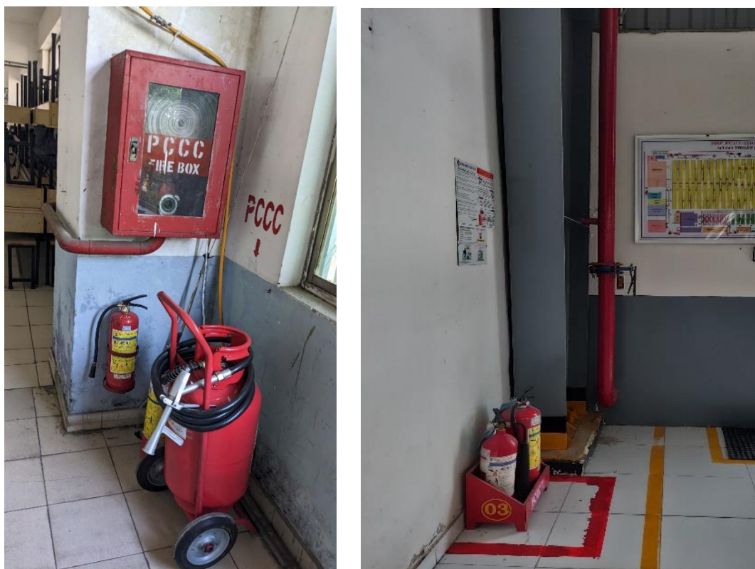
Hình 3.8. Hệ thống PCCC tại cơ sở
